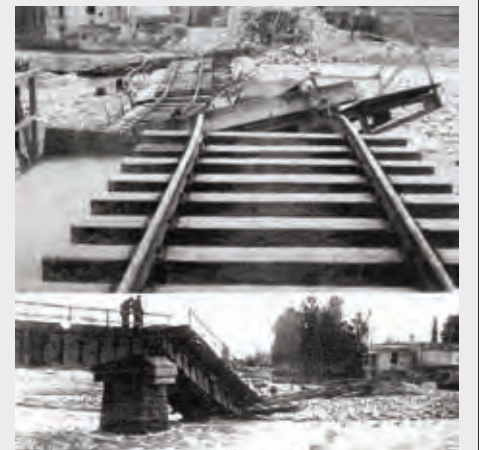
İskeçe tarihi tren köprüsünün havaya uçurulmuş hali.
